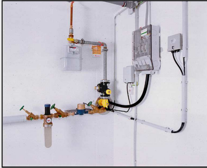
Hauptinstallation, übersichtlich und hochwertig
