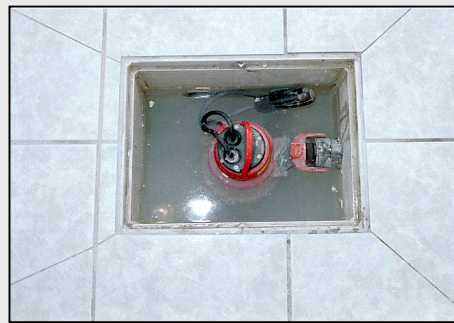
Zusätzlicher Bodenablauf mit Rückstauklappe und Pumpe
