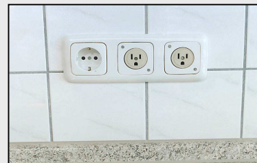
Zahlreiche Steckdosen 220 Volt und 125 Volt separat verlegt
