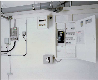
Sicherungskasten und Spannungswandler
