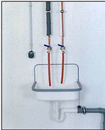
Ausgussbecken mit Kalt- und Warmanschluss
